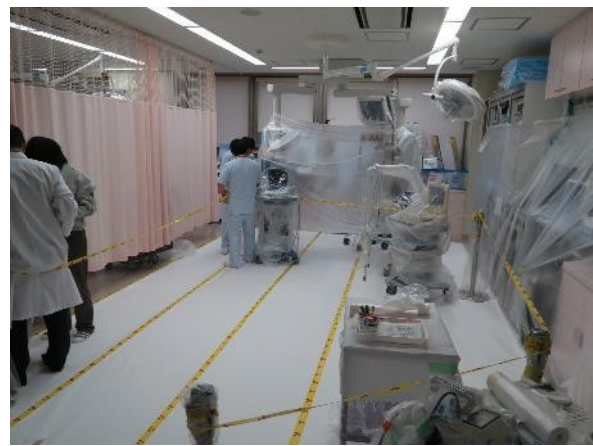
救命救急センター内に設けられた管理区域とその養生
