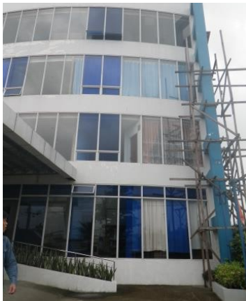
タクロバンドクターズ医療センターは台風ハイエンで破壊された正面のガラス窓をより厚いものに変更。まだ5階部分は屋根が再建されたのみで内部は当時のまま。
