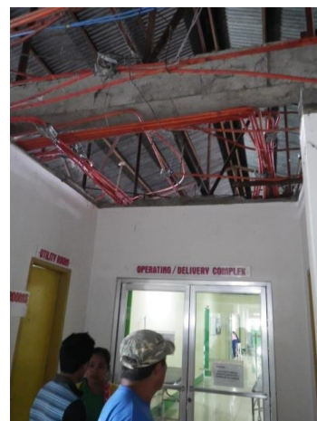
きれいに再建され稼働中のレイテ州立病院手術室、手前の天井ははがれたまま
